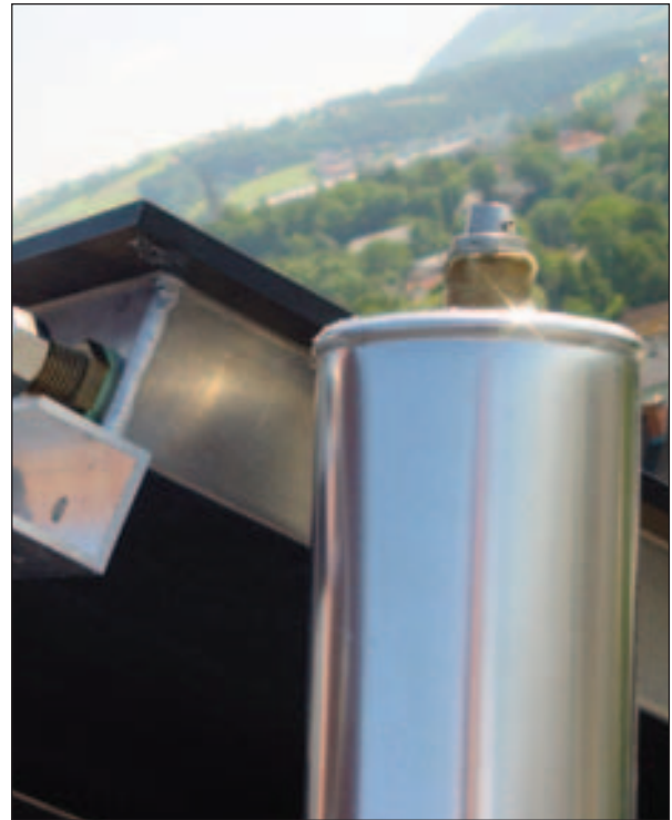
Abb. 6.14 eingebauter Automatikentlüfter; Quelle: (1)
