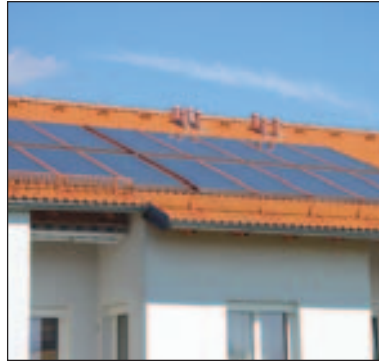
Abb. 2.9.4 Aufdachkollektorfläche; Quelle: ASiC
